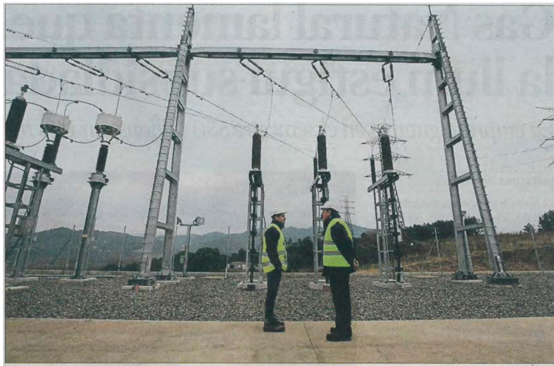
La subestació de la línia d'alta tensió de Bescanó
